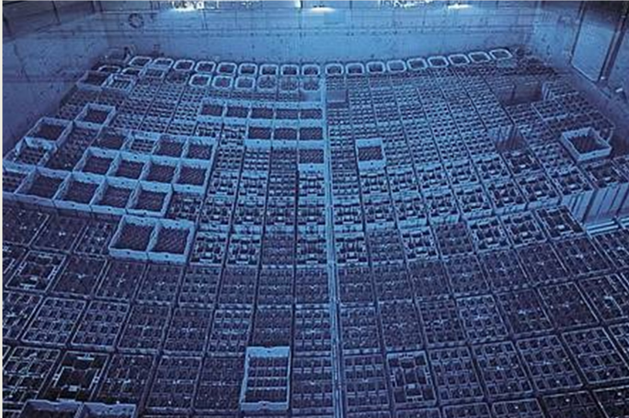
Zentrale unterirdische Nasslagerung CLAB (Tunnelröhren SZL Neckarwestheim)
